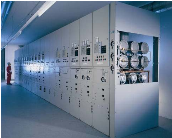
图2 运行中的中压开关柜
